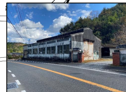
茶工場跡地 窓が割れやすく 通学時危険
