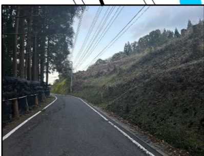
大雨時土砂崩れ注意!!
